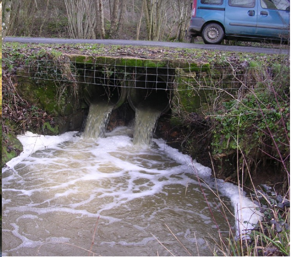
Seuil de pont mal calé/érosion
